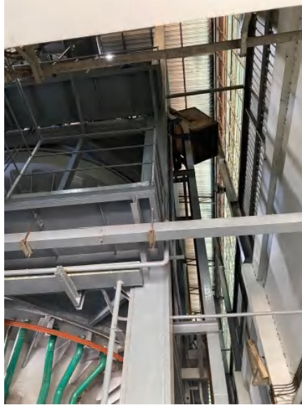
ภาพที่ ๕ การป้อนขยะเข้าสู่เตาเผาทางช่องเปิดด้านบนแบบอัตโนมัติที่สามารถกำหนดปริมาณขยะที่ป้อนได้
